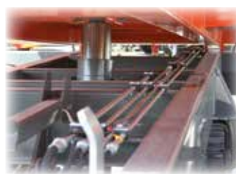
Système hydraulique en tuyau rigide
